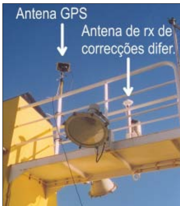
Fig. 1 – Antenas instaladas no NRP «Auriga»
