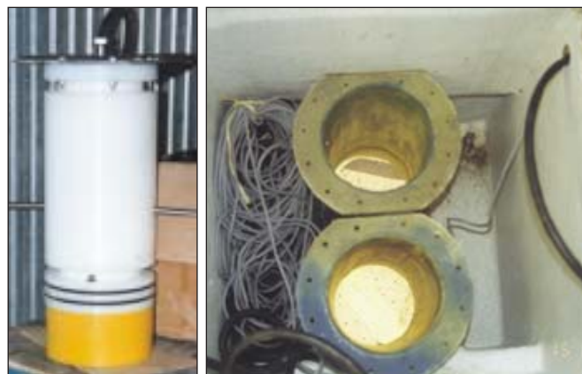
Fig. 9 - Aspecto dos transdutores e sua instalação
