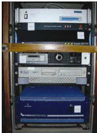
Disposição dos componentes no Rack 19
