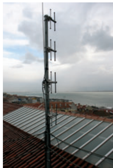
Antena direccional instalada no parque de antenas do IH-Trinas.
