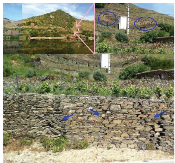
Fig. 2. Aspecto parcial do cais de Sabrosa, escorregamentos na encosta a montante e localização da rotura no muro de gabiões.
